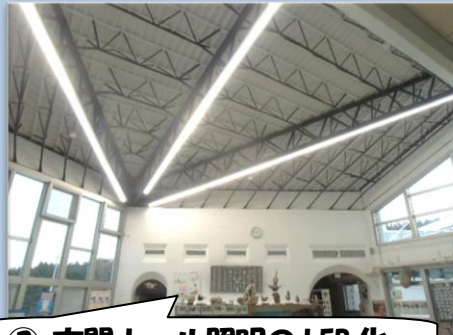
② 玄関ホール照明のLED化
