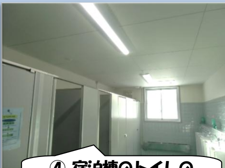
④ 宿泊棟のトイレの照明等の自動化
